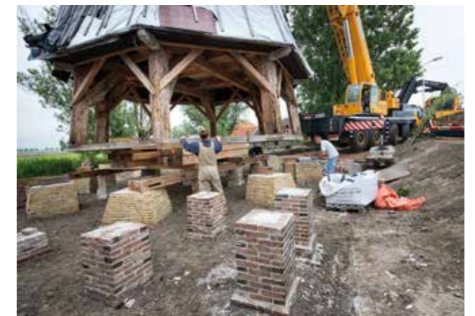
Het plaatsen van de molen met een zware kraan op het fundament is een uiterst secuur werkje. (© foto Alfons van Schijndel)
